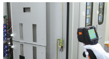
クリーンルーム内分電盤の温度点検
